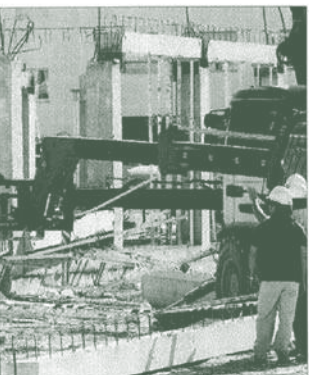
Una grúa retiraba ayer escombros tras el derrumbe en el colegio. A. C.
